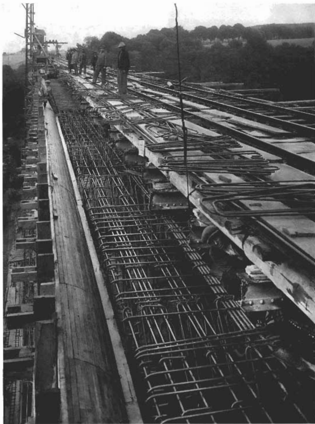
Le travail sur l'à pic de la rivière. On distingue l'armature des arcatures, les rails servant de coulisse pour le palan. On aperçoit en-dessous l'extrémité des poutrelles de l'ancien tablier.
